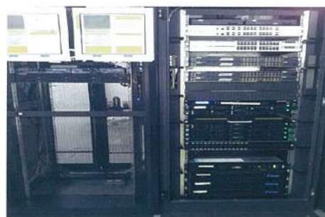
24時間安定稼働のデータセンター
