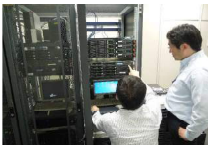
サーバー設定作業
